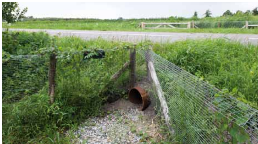
Faunabuis met begeleidend herkwerk
