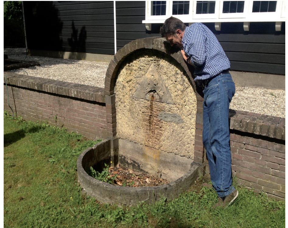
De villa kent een mooi grindterras met een gemetselde terrasrand, die vanuit het huis de overgang vormt naar het gazon. De rand van het terras is niet volledig. De muur is niet overal compleet en ornamenten, zoals dit kraantje zijn kapot.
