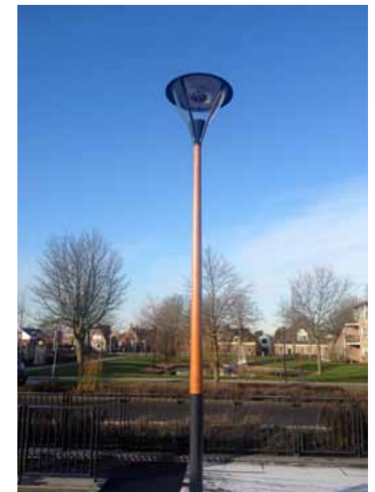
Lage houten lichtmast met armatuur
